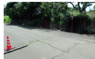
貯蔵庫前面の亀裂のに入った道路
