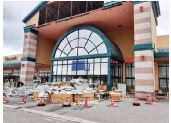
看板が破損した西面外壁
