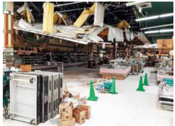
天井が複数箇所落下した青果売場
