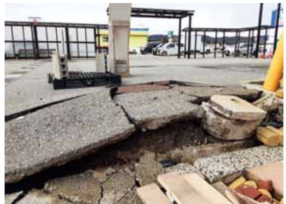
融雪管が複数箇所破損した駐車場
