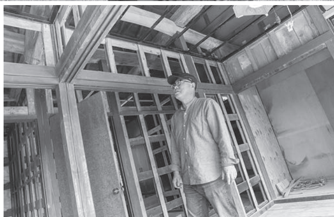
余震が起きると同時に、保育園での訓練通りこたつに潜り込んだ広空くんに続き大人もこたつへ。自宅にはまだブルーシートがかかる(上)屋根瓦も天井も落ちたが梁だけは無事だった2階。いずれ再建をしたいと昭治さん(下)
