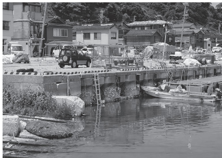
支柱に付着する白い貝は、海水に浸かっていた部分。漁港が隆起し、海面が1m以上上がった
