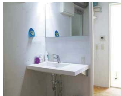
共用空間に設置されたシンプルで機能的な水回り。
