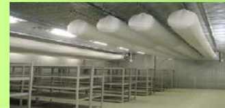
ソックダクト
