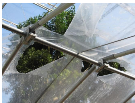
写真1 カラスに破かれたハウスフィルム
