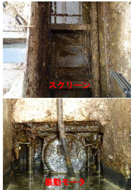
写真 ふん尿分離装置の概況
